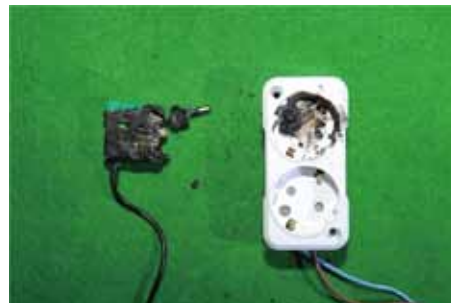
[그림 13] 어댑터와 전기콘센트의 연소상황
