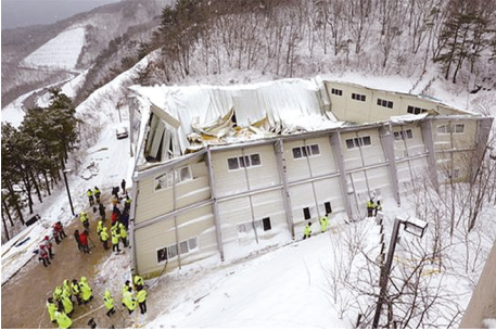
[사진 3] 마우나리조트 붕괴 사고
