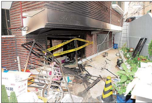
[그림 2] 안방 창문 : 창문을 통해 화염과 그을음이 분출되었으며 창문으로부터 3m 가량 떨어진 화단에서 창문의 유리파편이 발견됨
