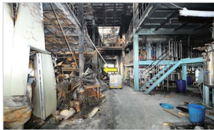
[사진 11] 화재현장 내부의 연소상황
