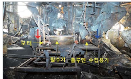
[사진 12] 탈수기 주위의 연소상황
