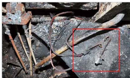
[사진 15] [사진 12]의 ↓표지방향, 접지클램프가 이탈된 상황 (□ 부분은 접지클램프)
