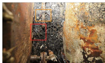
[사진 16] [사진 12]의 ↓표지방향, 접지클램프가 이탈된 상황 (□, □, 부분은 접지클램프)
