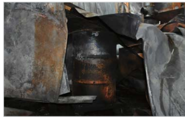
[사진 3] 점착제 용기 및 그 주위의 연소상황
