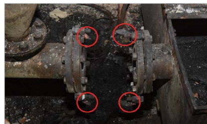
[사진 14] 탈수기와 톨루엔 수집용기를 연결하는 배관에 설치된 본딩선의 상황 (○ 표지는 본딩선)
