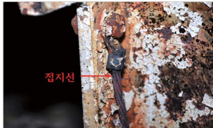
[사진 13] 접지선의 연소상황 (페인트 위에 접지선을 체결한 상황)
