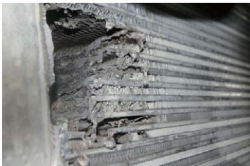
[사진 10] 냉각쿨러 파손
