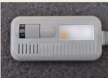
[사진 8] 온도조절기의 상황 (과열흔적 또는 탄화흔적이 없음)
