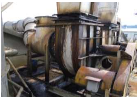
<배기팬 병렬 설치 모습>
