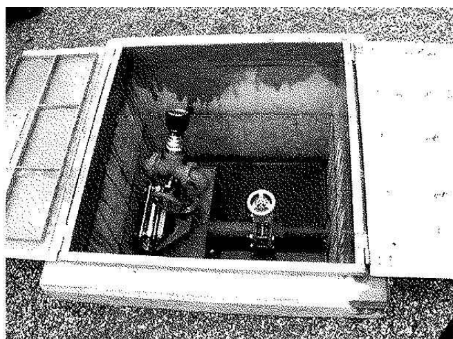
[사진 6] 지하피트 설치 예
