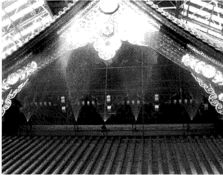
[사진9] 드렌처 설비 설치 예(2)
