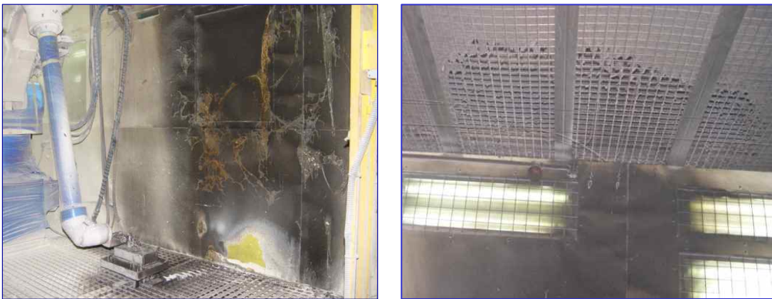
[화재 진압 후 도장부스 벽면 및 도장부스 천장]
