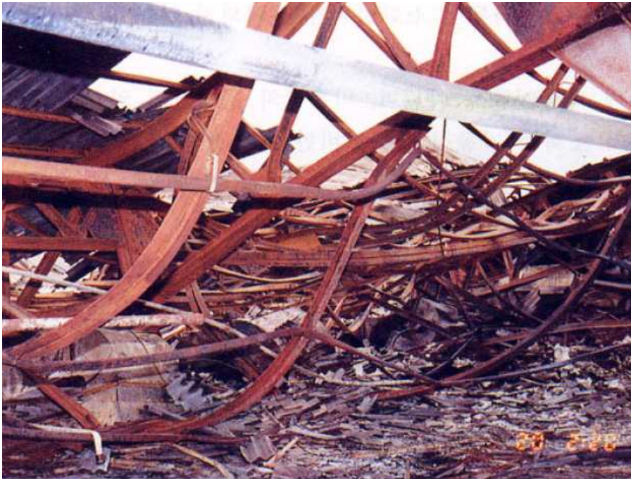
[사진 1] 화재의 열로 인해 붕괴한 공장 남측 지붕틀
