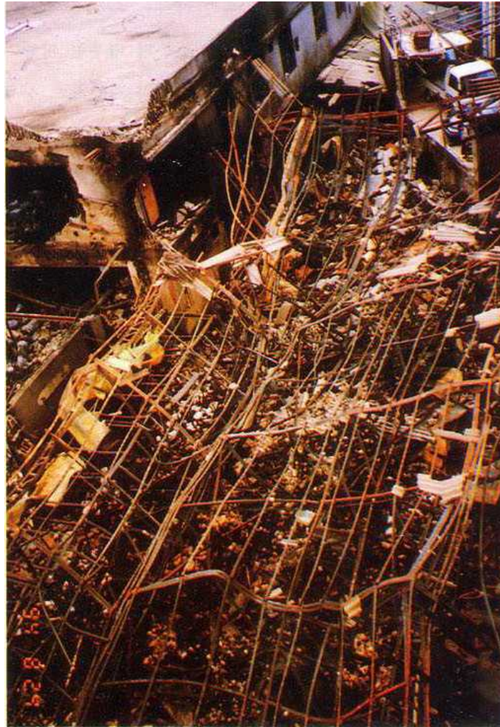
[사진 1] 고열로 지붕이 붕괴된 모습
