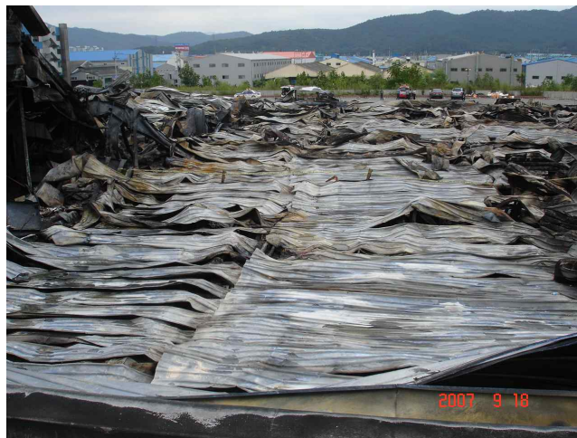
[사진 4] SB 생산설비 2 라인 피해 현장
