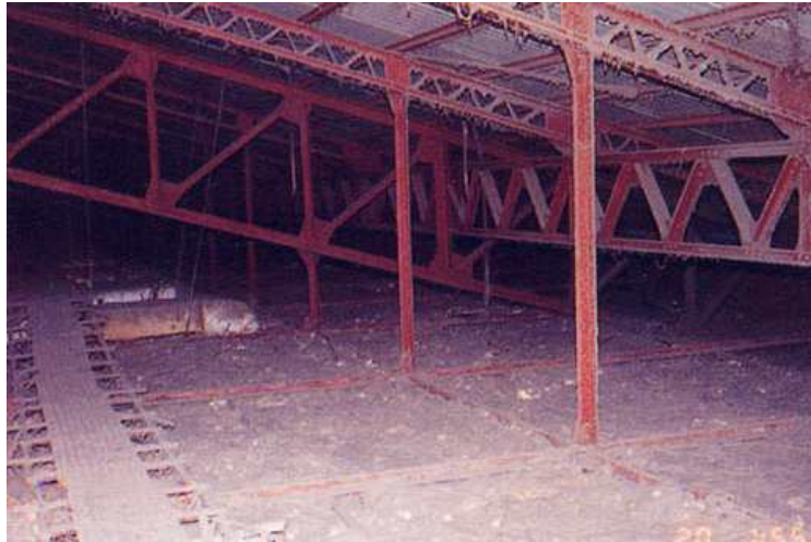
[사진 4] 화재피해를 입지 않은 동쪽 끝의 지붕(섬유분진이 쌓임)
