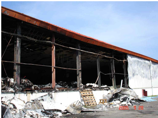
[사진 3] 혼타면 공정 벽체 : 발화지점 인근에 위치하여 소손정도가 심하였다.
