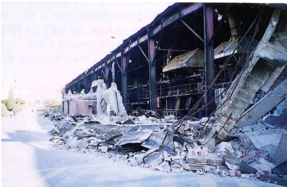
[사진 2] 건물 북쪽 외벽이 붕괴된 모습
