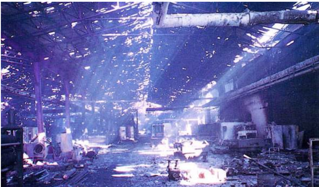
[사진 4] 화재 후 내부의 모습- 방화구획의 미비로 내부 전체가 소실되었다.
