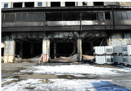
[사진 7] 외벽에 가연성 심재가 포함된 샌드위치 패널 사용
