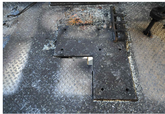
[사진 6] 용접 작업장소 바닥내 개구부
