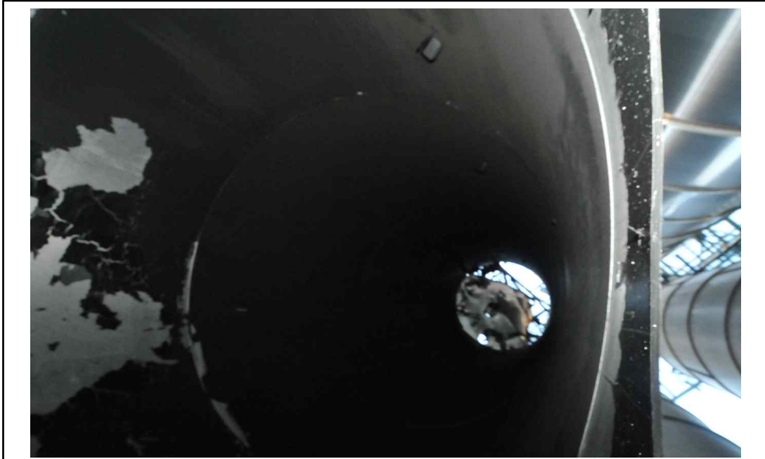
[사진 5] 폭발한 사이로① 상부의 상황 (파열되어 개방된 상태)
