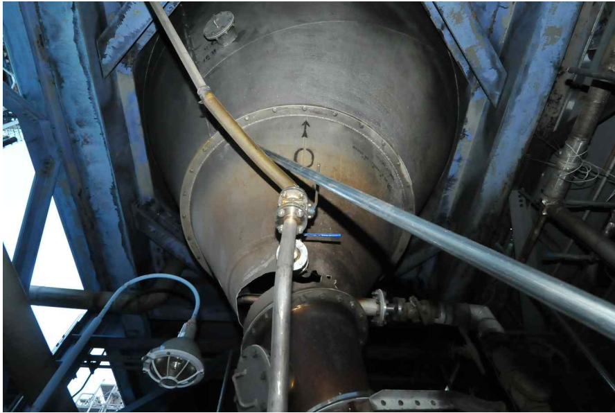
[사진 7] 폭발한 사이로② 하부의 상황 (급격한 부압 및 충격에 의한 파열)
