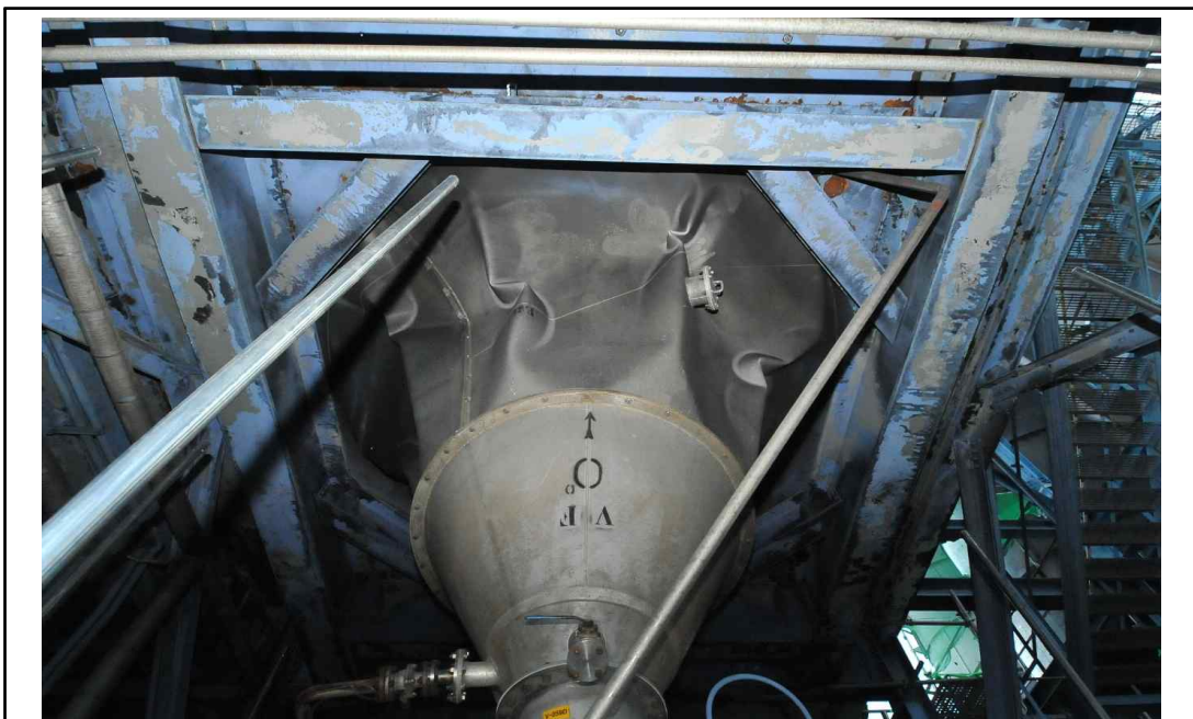
[사진 6] 폭발한 사이로① 하부의 상황 (급격한 부압에 의한 손상)
