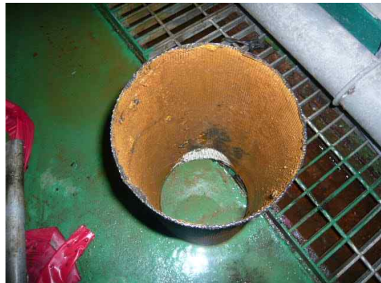
[사진 2] 스트레이너의 막힘 발생
