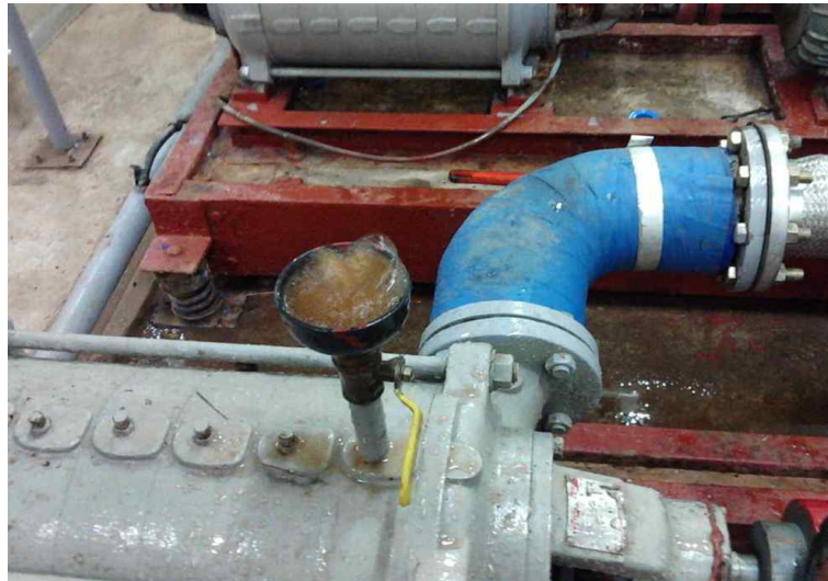
[사진 3] 소방펌프 내 녹물 배출
