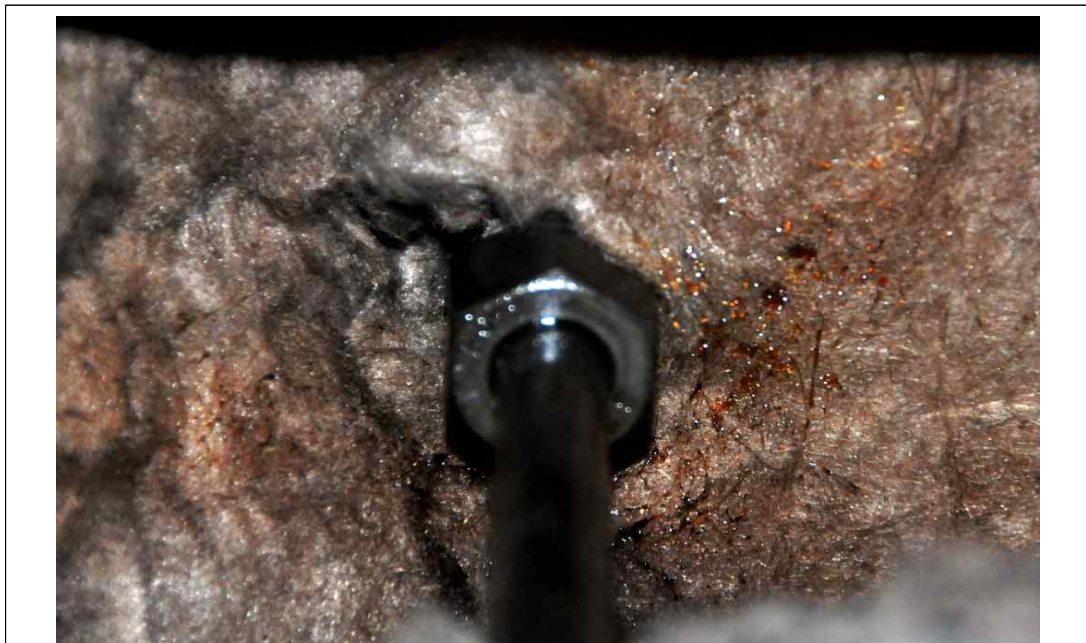
[사진10] 사진9의 □표지부분, 밸브 이음부에 작동유 누출 흔적
