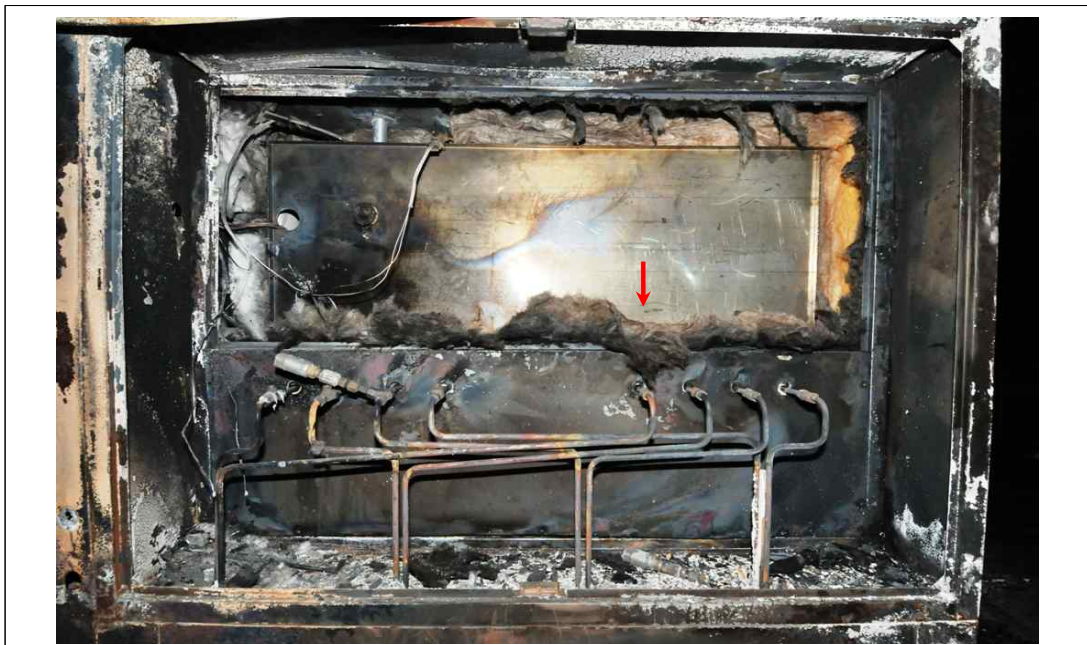
[사진 8] 사진6의 □표지부분, 단열재를 제거한 상황(시험장치로 유도되는 작동유 배관의 상황
