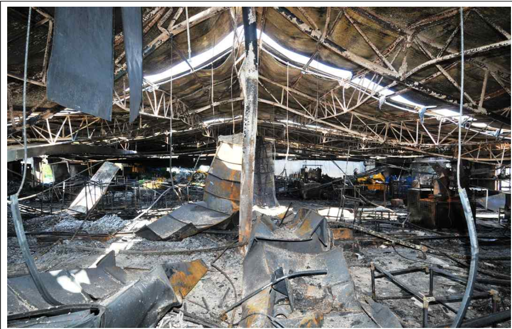
[사진 4] 2층 작업장의 연소상황(우측 방향의 상황)
