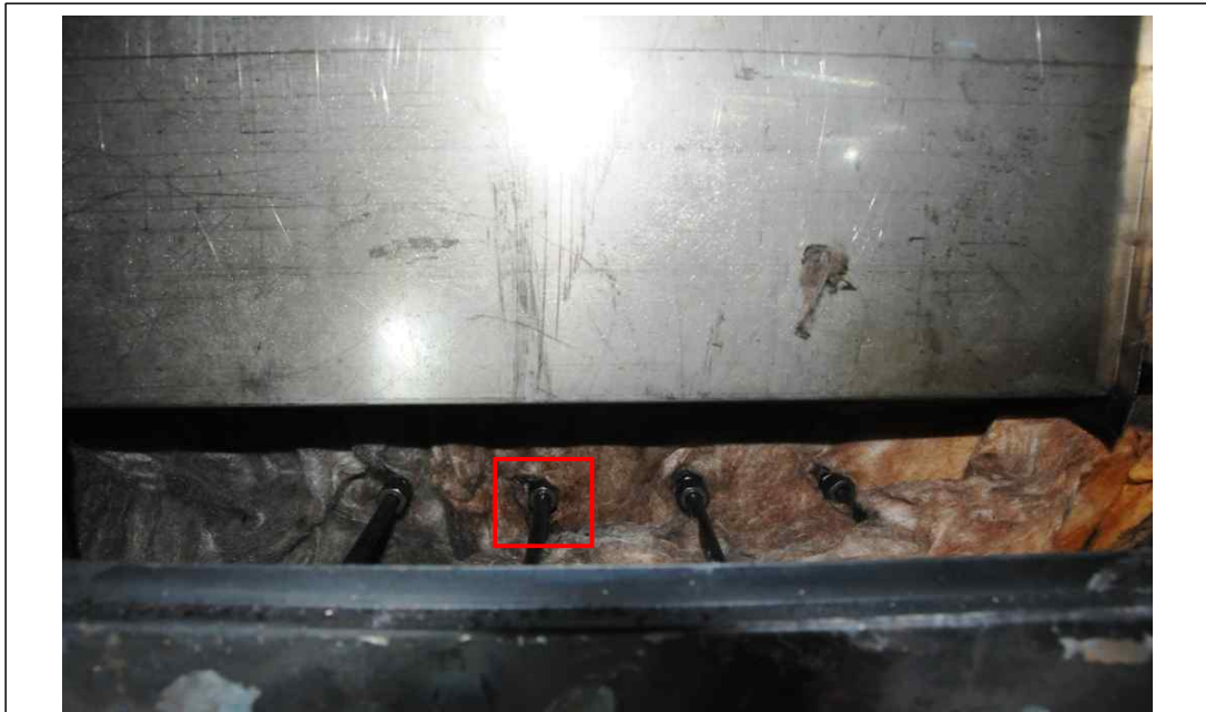
[사진 9] 사진8의 ↓표지방향, 작동유 배관의 상황
