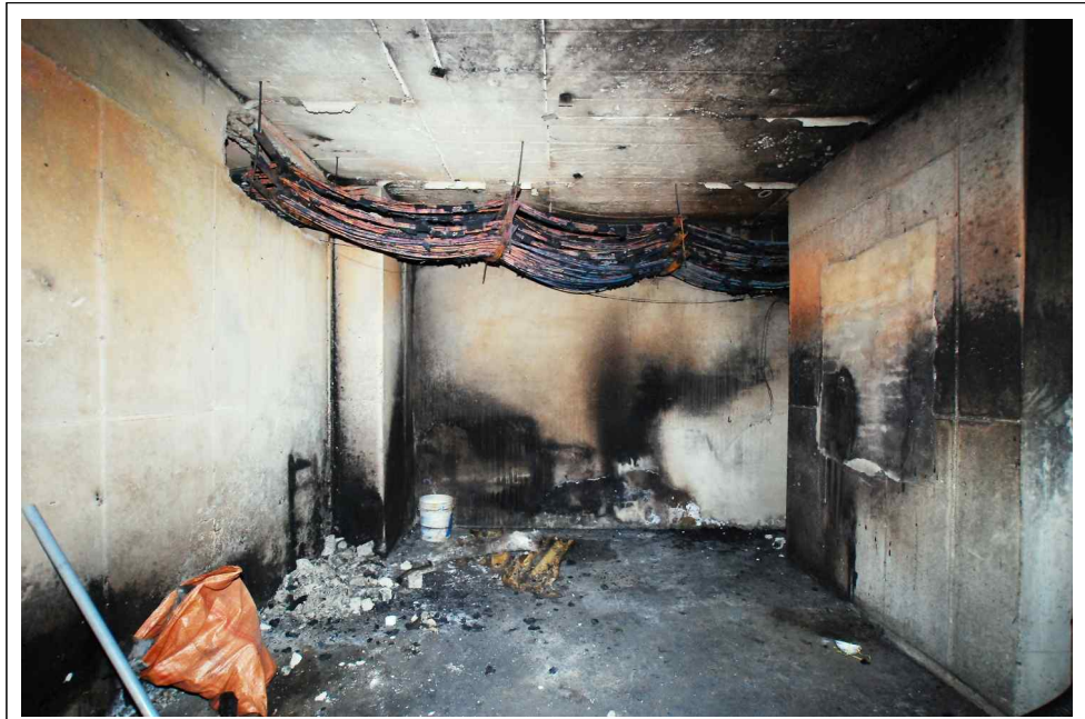
[사진 1] 케이블트레이 및 주위의 연소상황
