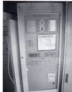
[사진 7] 사무실에 설치된 자동화재 경보설비 수신기(GR형)
