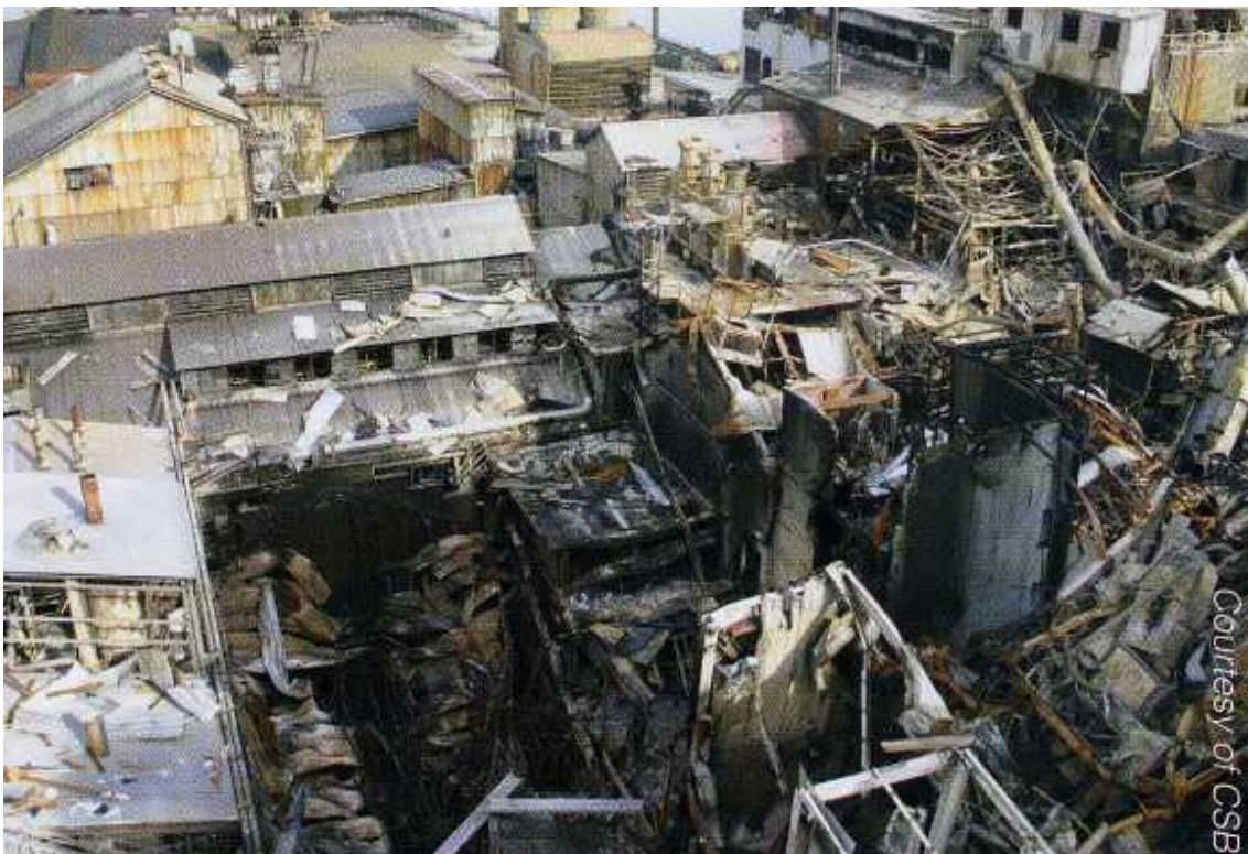
[그림 6] 과도한 설탕분진이 몇 인치씩 수평면에 쌓여 있을 가능성 등으로 인해 미국 조지아주 소재 임페리얼 설탕공장에서 치명적인 분진 폭발을 야기했다.
