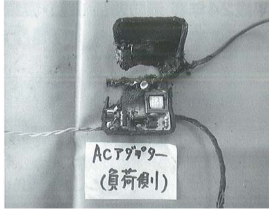
[사진 11] 충전기② 내부 소손 상황
