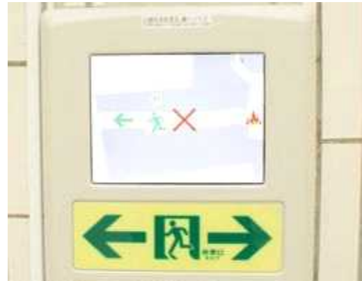
[사진 8] 화재감지기 작동 시의 단말기 예
