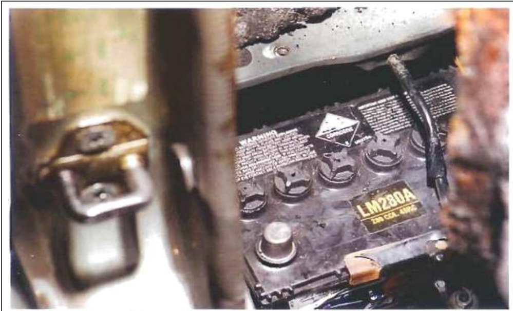
[ 축전지의 접속단자가 앞쪽을 향하도록 설치된 모습 ]
