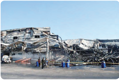
사진 4. 화재 후 전면부 소실 현장
