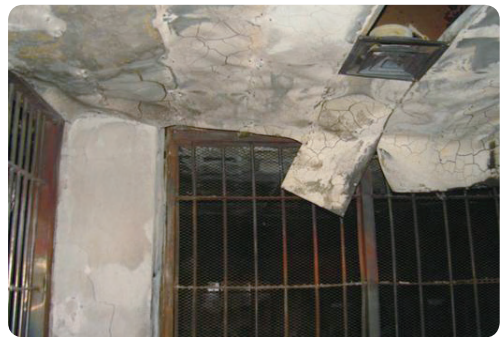
사진 3. 사물함 상단의 천장 소손(304호)
