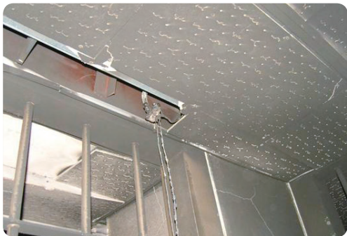
사진 5. 304호 감시카메라 소손 흔적
