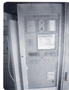
사진 7. 사무실에 설치된 자동화재탐지설비 수신기(GR형)
