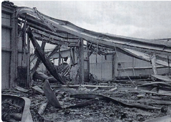
사진 5. 3층 철골대들보가 현저하게 휘어지고 콘크리트 슬라브 전면이 폭발로 파괴
