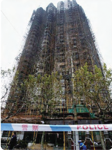
사진 9. 화재발생 후 건물 외관
