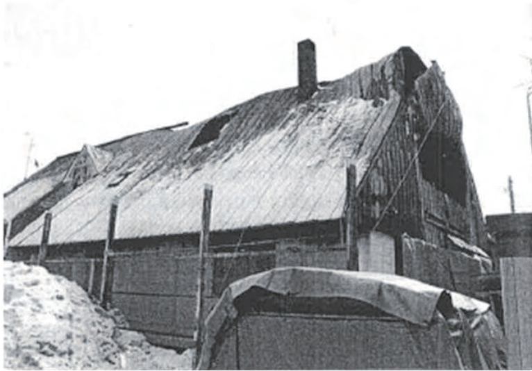
사진 1. 화재발생 건물 외관
