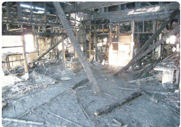
사진 2. 식당 내부 화재현장 사진
