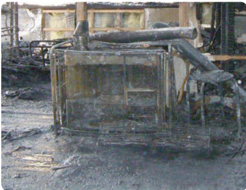
사진 3. 식당 내부 화재발생 석유난로
