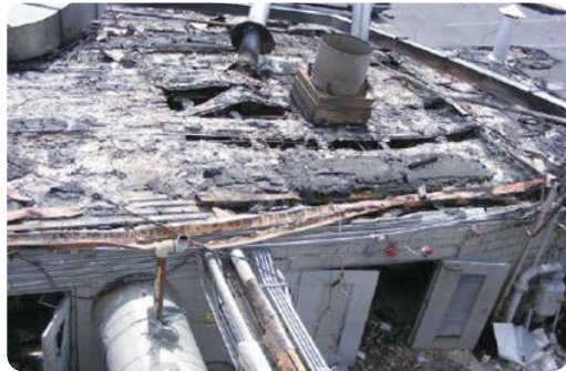
사진 3. 지붕 및 실험/운영동 북쪽 벽 손상 피해
