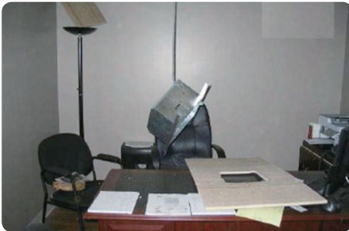
사진 4. 주변 사무실 손상 피해
