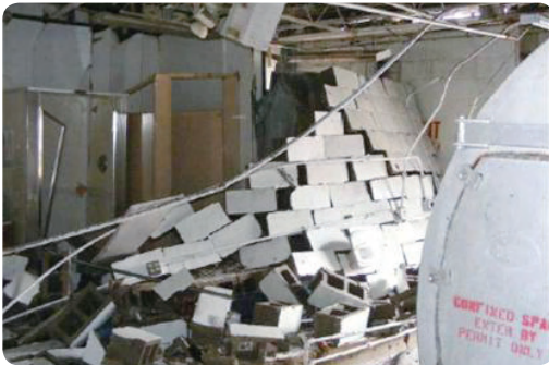
사진 2. 보일러실과 라커룸 손상 피해
